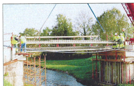
Pour l'entreprise montchaninoise TEGC, le pont de Blanzay (d'une structure similaire à celle utilisée ici à Palinges) représente une commande de 380 000 € hors taxe et 2 000 heures de travail
